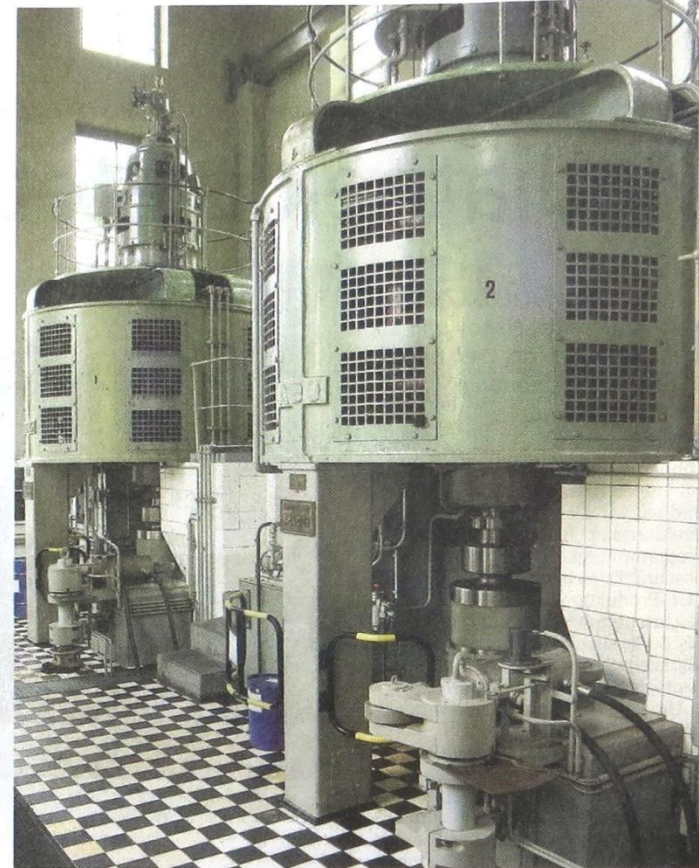
Angetrieben von einer Francis- und einer Kaplan turbine, erzeugen die Generatoren im Kraftwerk Ohl Grünscheid zusammen etwa 4,5 Mio. kWh elektrische Energie pro Jahr.
